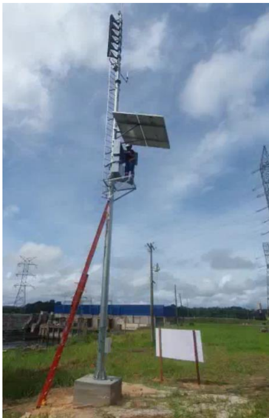
Figura 9. Sistema de Alerta Sonoro ZAS FGE - Torre 01
