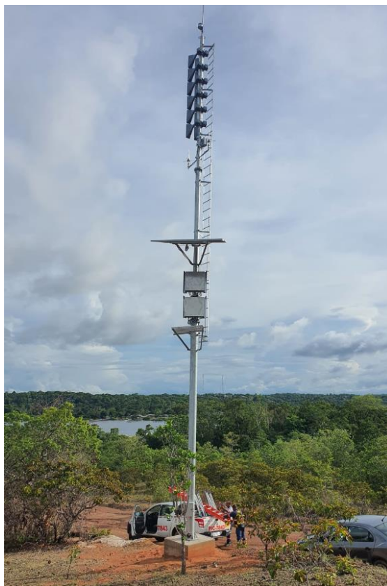
Figura 10. Sistema de Alerta Sonoro ZAS FGE - Torre 02
