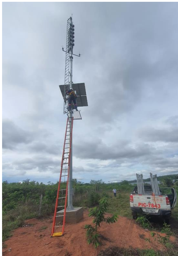
Figura 11. Sistema de Alerta Sonoro ZAS FGE - Torre 03
