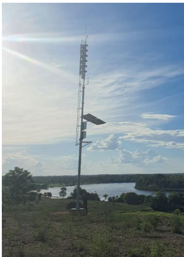
Figura 12. Sistema de Alerta Sonoro ZAS FGE - Torre 04
