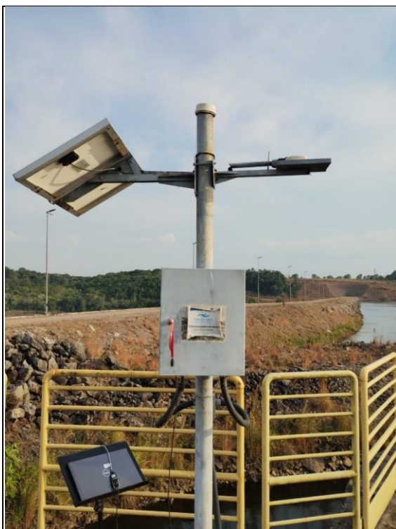
Figura 21 – Barramento – PCD, Painel Solar e modem de transmissão.
