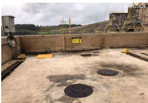
ETE 1 – Casa de Força (elevação 14)
