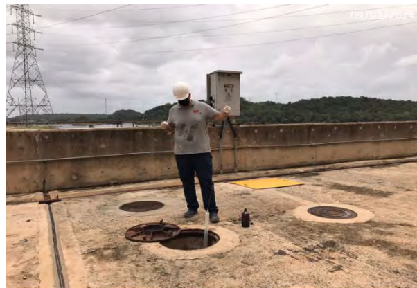
Coleta de efluentes na saída da caixa SAO.
