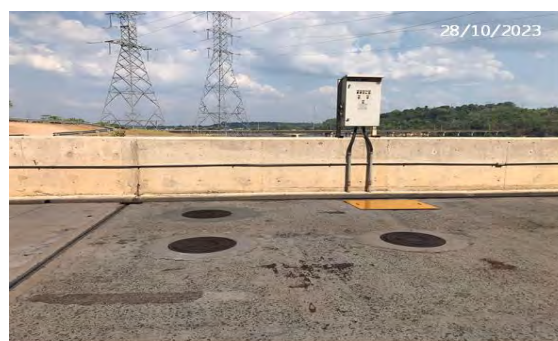
CSAO 2 – Transformadores e gerador (elevação 14)
