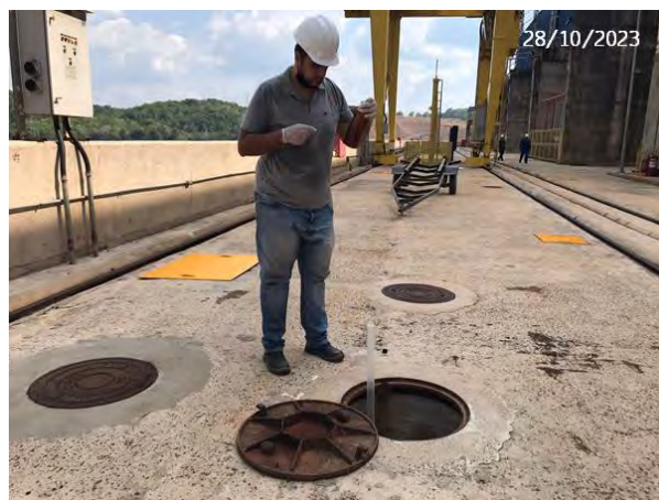
Coleta de efluentes na saída da caixa SAO.
