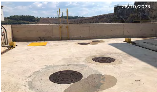
ETE 1 – Casa de Força (elevação 14)
