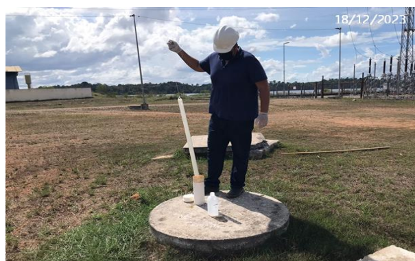
Coleta de efluentes na fossa séptica.
