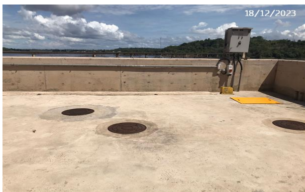
ETE 1 – Casa de Força (elevação 14)
