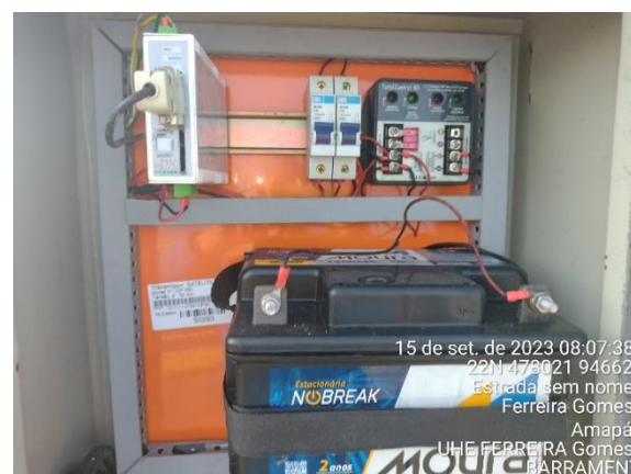
Figura 6 - Barramento – Vista interna PCD.
