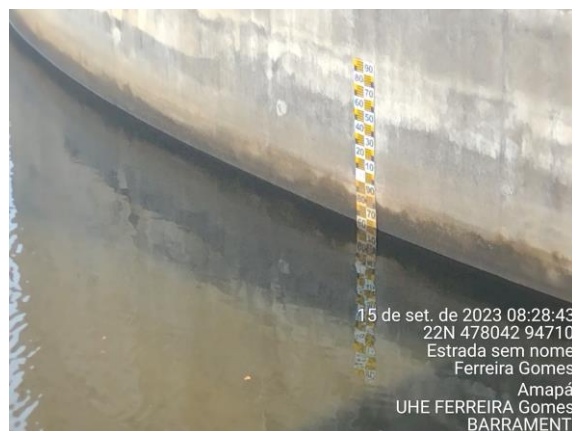
Figura 8 - Barramento – Régua NA.
