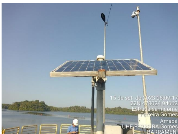
Figura 7 - Barramento – Pannel solar.
