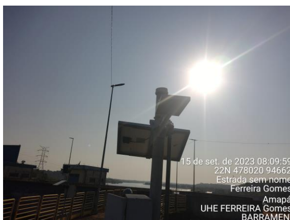
Figura 5 - Barramento – Vista externa PCD.
