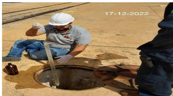
CSAO 2 – Transformadores e gerador (elevação 14)
